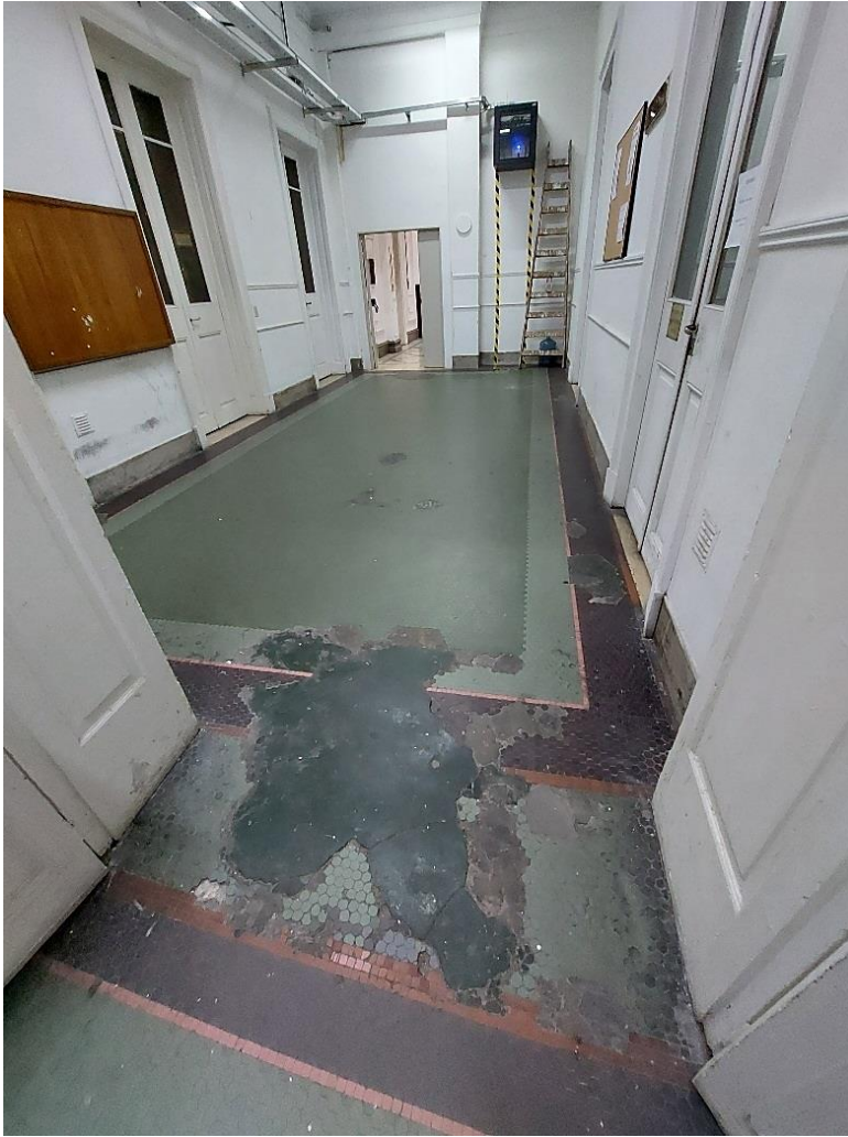
ILUSTRACIÓN 4. DETERIORO AVANZADO DEBIDO AL ALTO TRÁNSITO EN ZONA DE ACCESO
