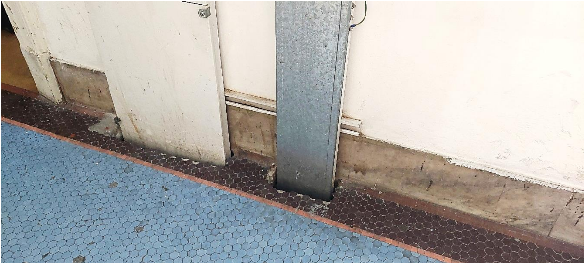
ILUSTRACIÓN 6. LA INSTALACIÓN DE LA BANDEJA MONTANTE DE CABLES RESULTÓ EN LA REMOCIÓN DE TESELAS ORIGINALES
