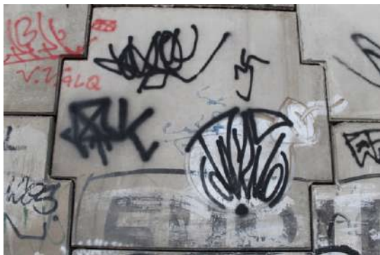
Figura 16. Pixos o pixação realizado por autores desconocidos utilizando pintura en aerosol sobre muro de concreto. Foto: Pedroza Amarillas, 2014.
